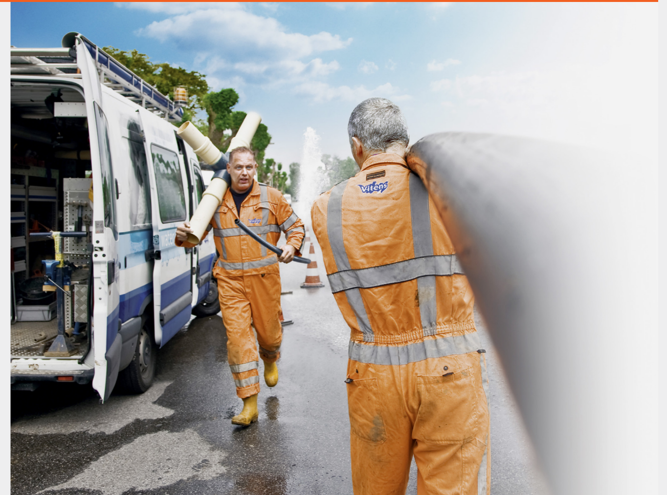
CGI maakte voor waterbedrijf Vitens een toepassing waarmee het, met behulp van analyse van big en open data, lekkages en andere schade sneller kan opsporen en herstellen.
